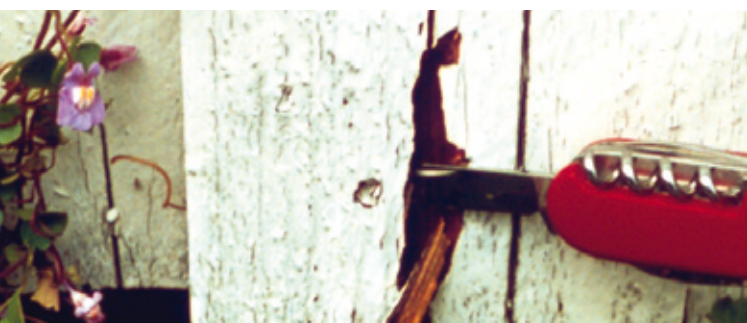
Holzfäule entsteht durch schlechten Holzschutz
